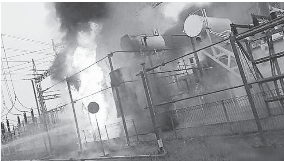
1巨港查卡巴灵蒸汽发电站一个变压器发生短路造成爆炸。
