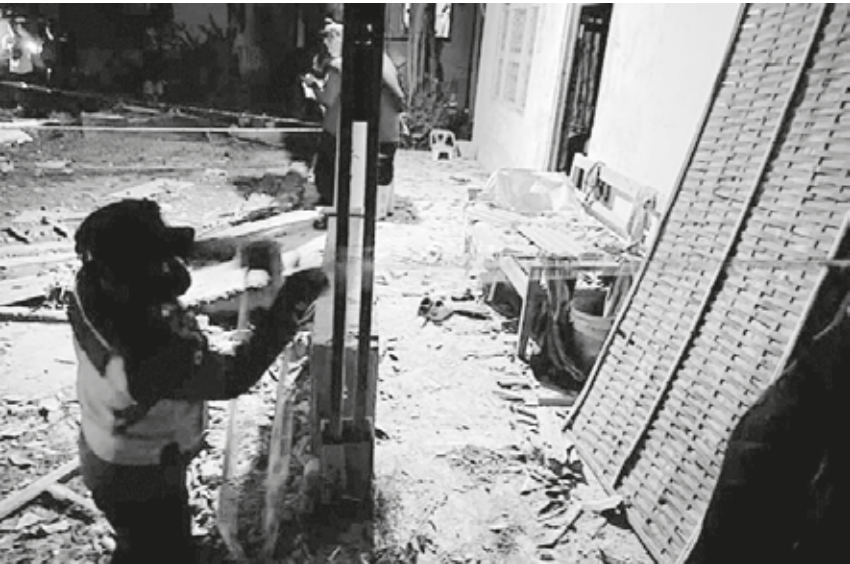
据称由鞭炮引起的强力爆炸，毁坏了25间房屋。
