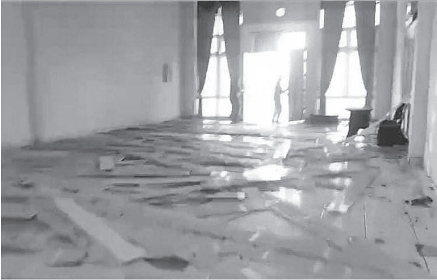
►库邦县长办公室建筑物的天花板掉在地上。
