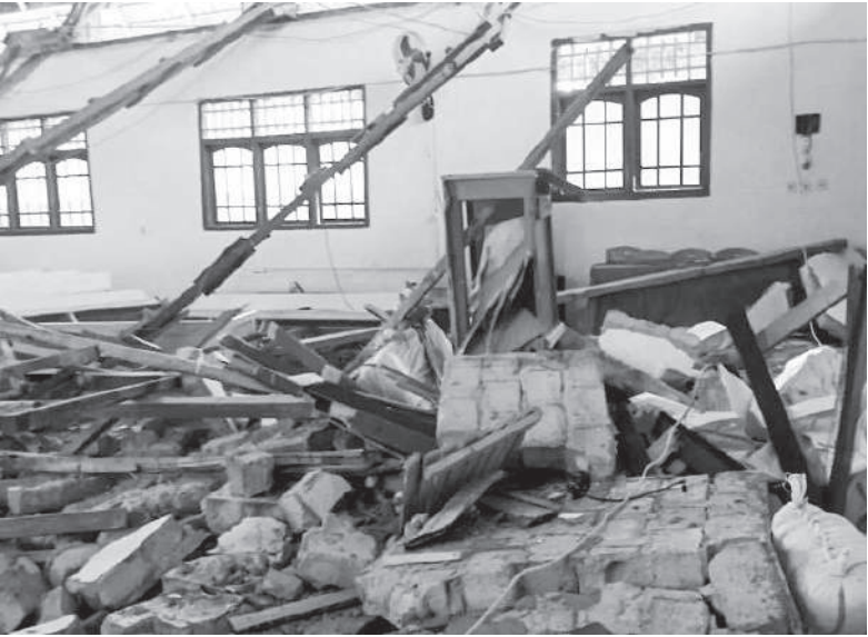
波梭县地震造成数十座建筑物受损。
