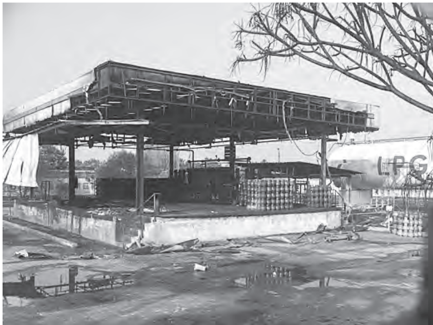
火灾几乎严重损毁整个散装液化石油气充气站区域。
