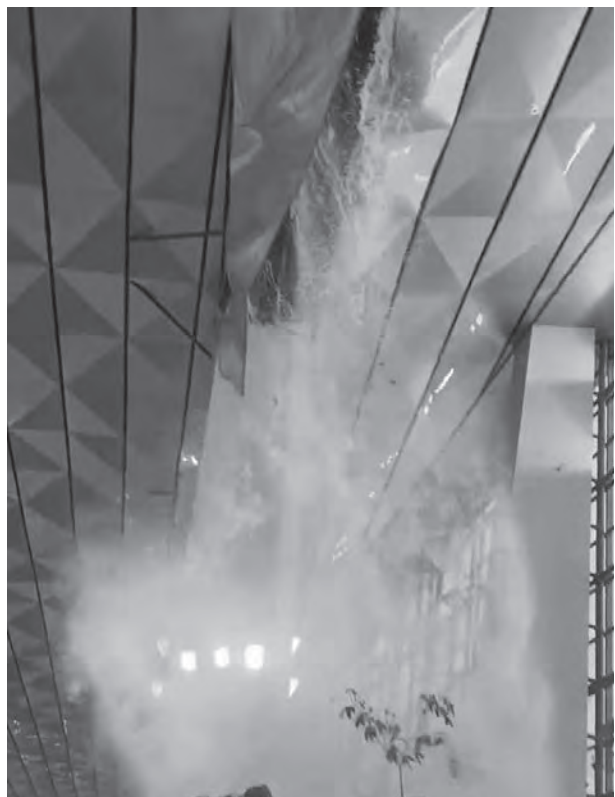
雨水从天花板大量涌下，影响航站楼内旅客的活动和通行。
