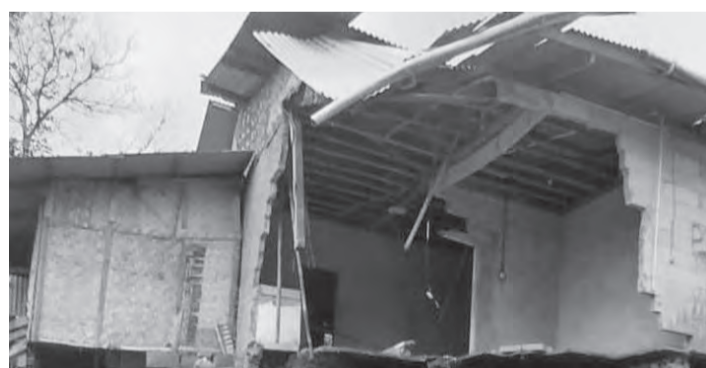
多栋房屋受损。
