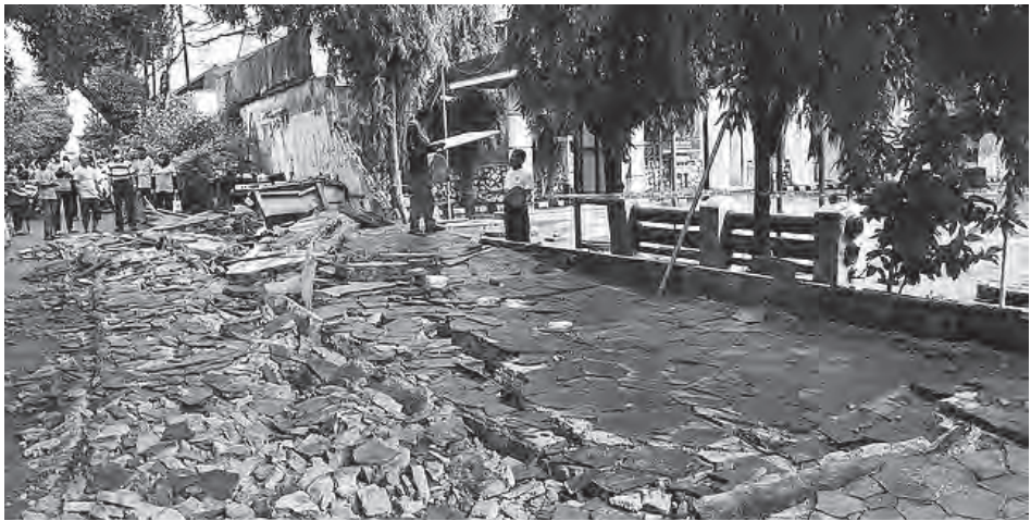
小学的围墙倒塌。
